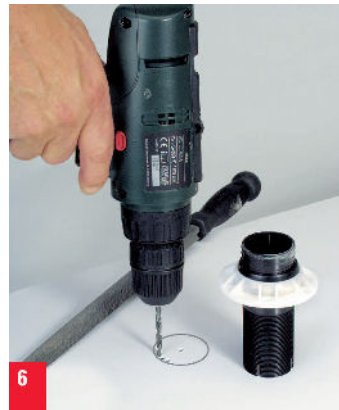
6. Wenn kein Kreisbohrer vorhanden ist, Loch von \varnothing 38 mm für die Dachdurchführung zeichnen und ausbohren.
